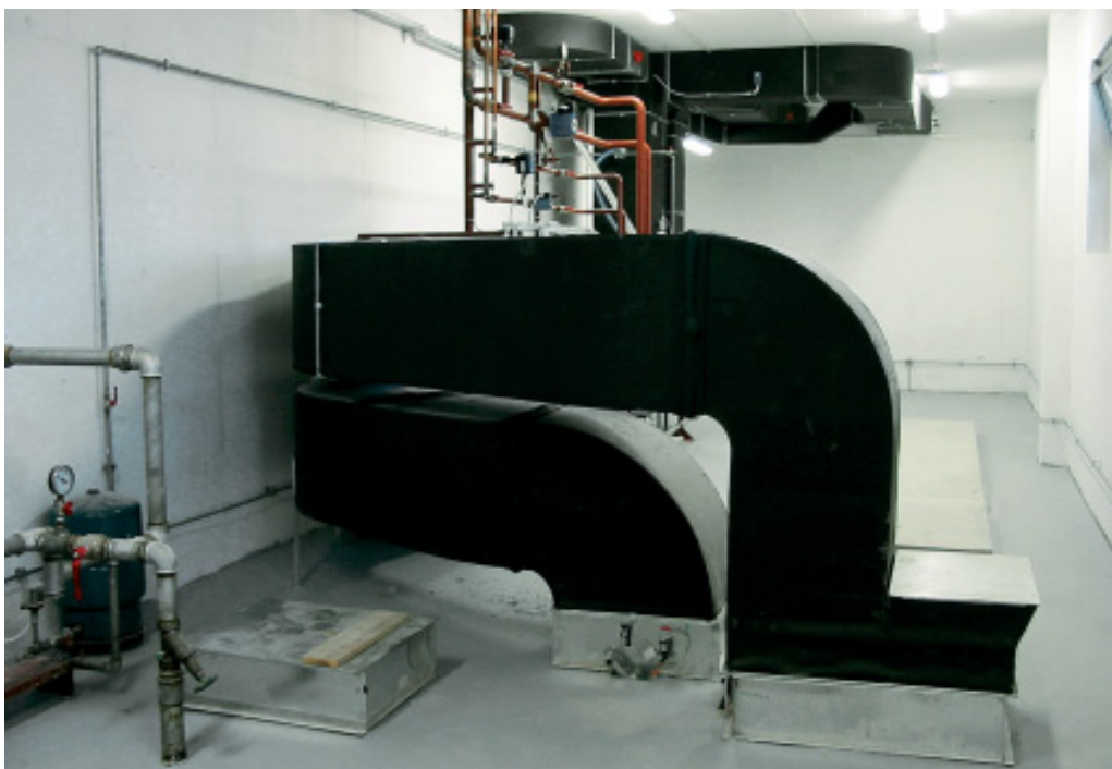
Razvodi za zrak in požarne lopute za preprečitev požara po kanalih.
