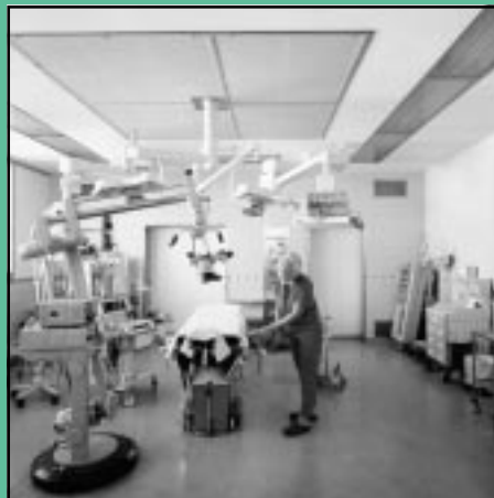
Klimatizacija operacijskih prostorov
