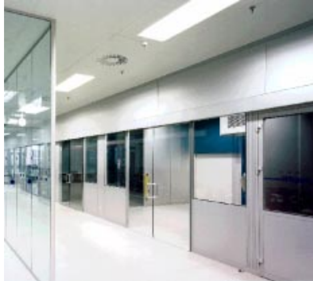
Klimatizacija operacijskih prostorov
